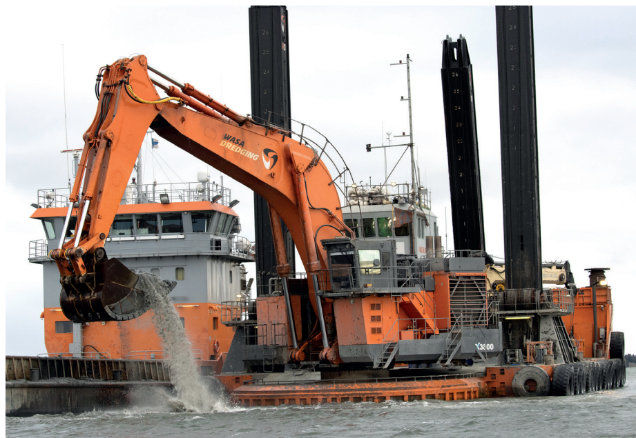
Med den här tekniken kommer sprängstenen att muddras. Bilden från muddringen av farleden till Hargs Hamn utanför Uppsala i höst.
